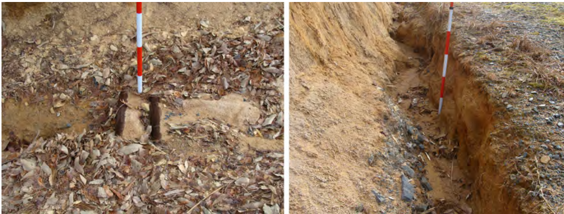
写真 6-5 排水施設の状況及び侵食状況
