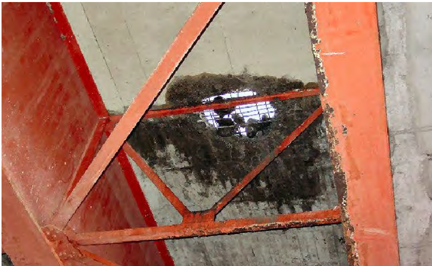
写真番号 9.1.1 説明 コンクリート床版が抜け落ちた例
