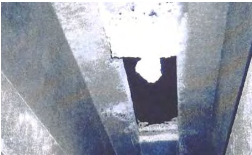
写真番号 9.1.2 説明 T桁橋の間詰め部のコンクリートが抜け落ちた例
