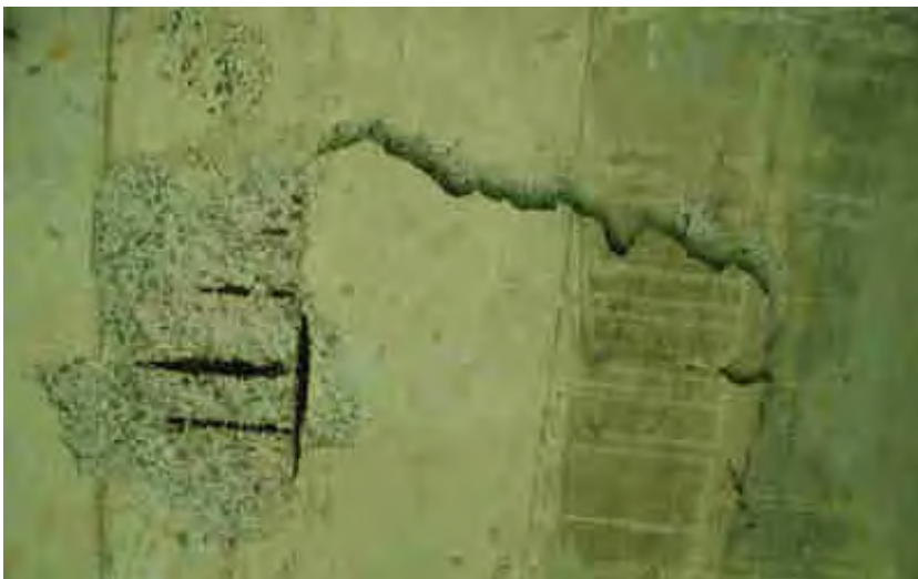
写真番号 7.1.2 説明 床版下面に広がりのある剥離・鉄筋露出が生じた例
