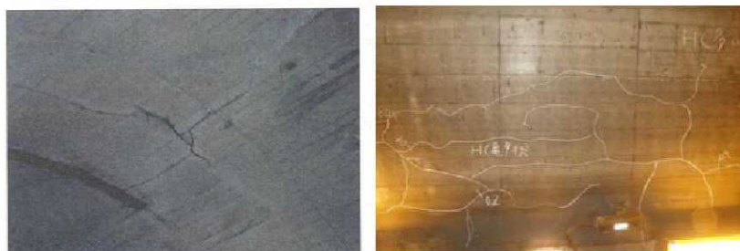
付写真-1.4.1 複数のひび割れで覆工コンクリートがブロック化している例
