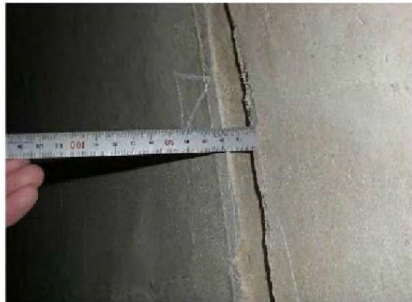
付写真-1.4.4 段差の例
