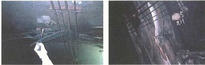
付写真-1.4.5 補修モルタルが劣化してはく離している例
