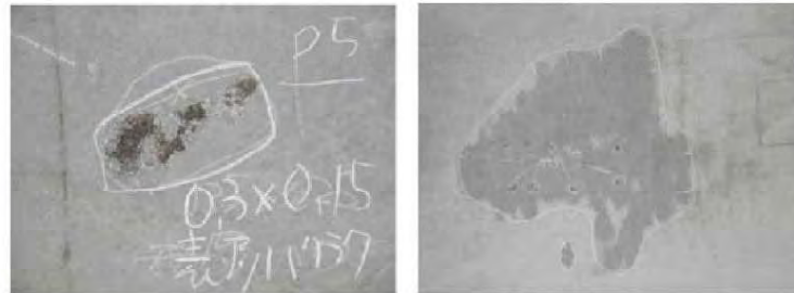
付写真-1.4.2 覆工コンクリートが変色している例 (うき・はく離を伴う)
