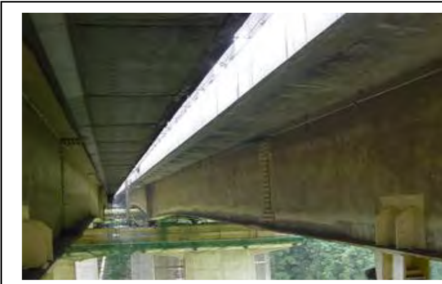
写真番号 16.1.9 説明 鋼部材の塗膜に汚れが付着して変色した例
