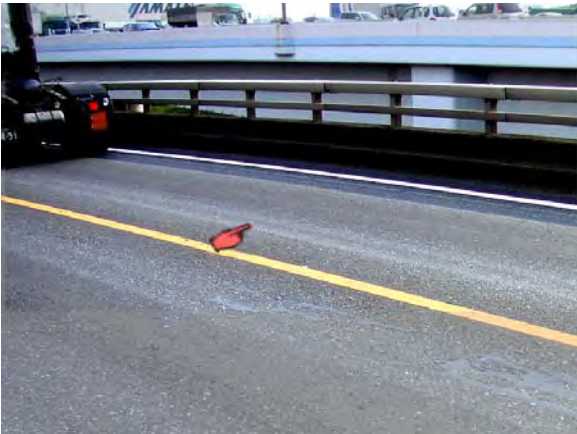
【輪荷重の荷重による舗装の流動によるもの】
