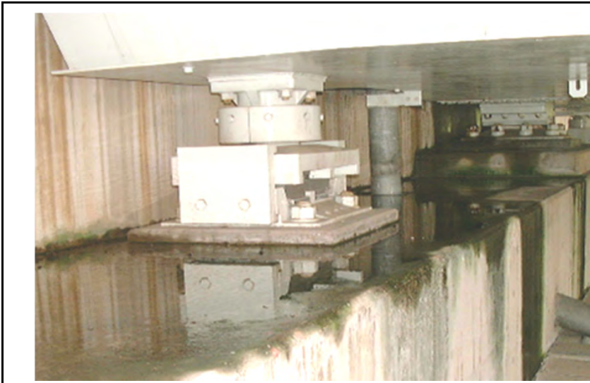
写真番号 19.1.3 説明 橋座に滞水した例
