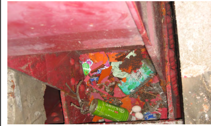
写真番号 16.1.11 説明 鋼材内部にゴミが堆積した例 鋼桁を腐食させることがあり、目視点検も難しいので、投物対策の実施が必要
