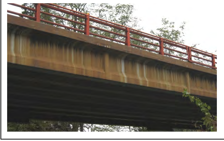
写真番号 16.1.8 説明 コンクリート表面に鉄分が付着して変色した例
