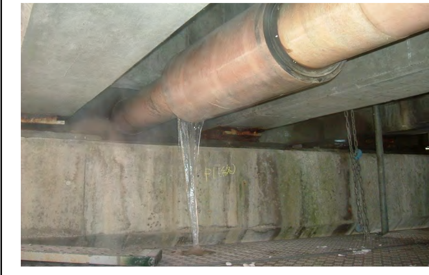
写真番号 16.1.10 説明 添架物件の水道管の継手部からの漏水の例 (つららとなっている)
