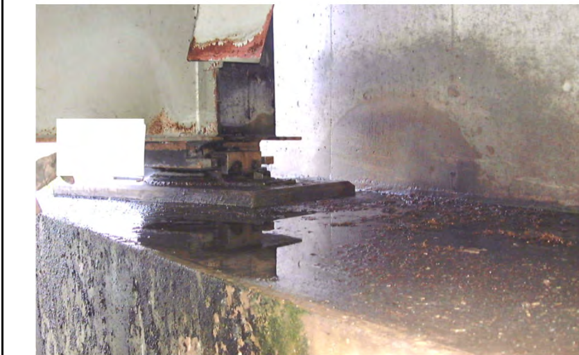
写真番号 19.1.4 説明 橋座に滞水した例
