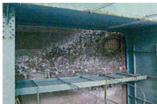
抜け落ち部の床版下面状況
