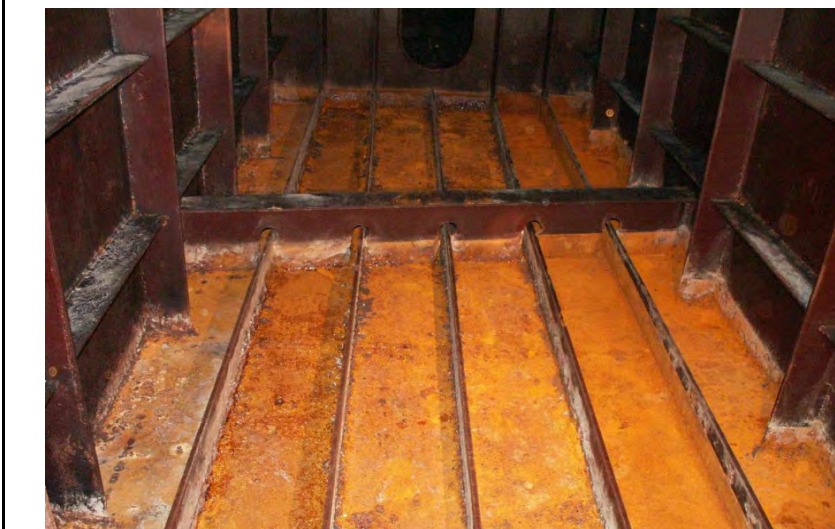
写真番号 19.1.5 説明 箱桁内部に滞水した例
