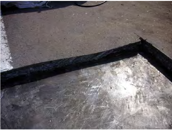
【舗装の摩耗によるもの】
