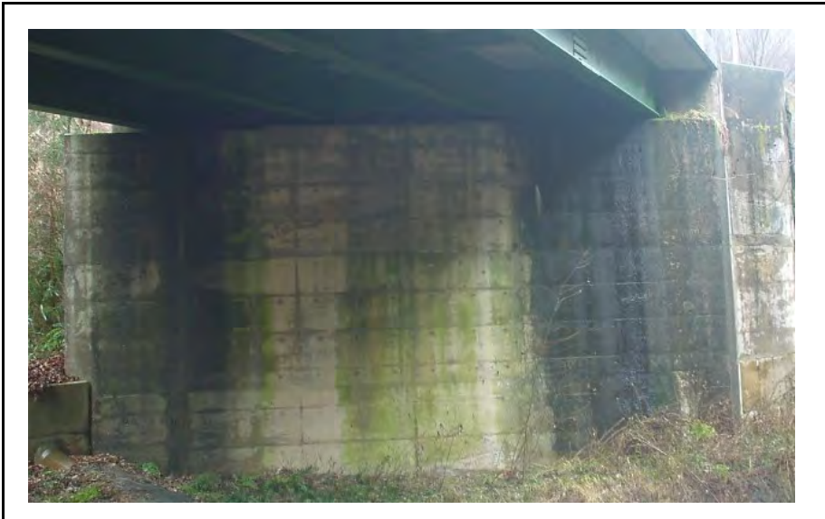
写真番号 16.1.6 説明 コンクリート部材の表面を伝う水によって苔が付着して変色した例
