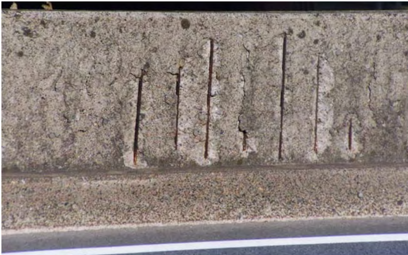
写真番号 7.1.1 説明 剛性防護柵に, 剥離・鉄筋露出が生じた例
