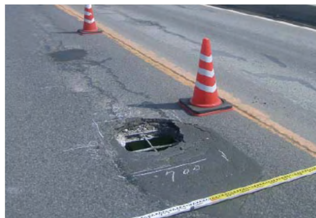
上記損傷が見られた橋梁では、床版の抜け落ちが発生した。
