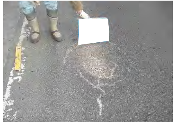
蜘蛛の巣状のひびわれから石灰分の浸出が見られる。
