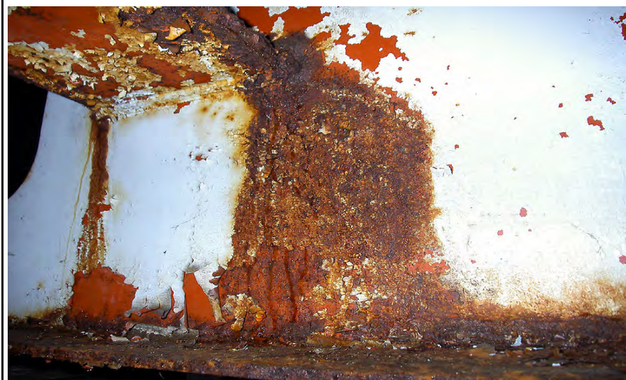
写真番号 1.1.2 説明 錆が極度に進行し、板厚減少が生じた例(塗装橋)
