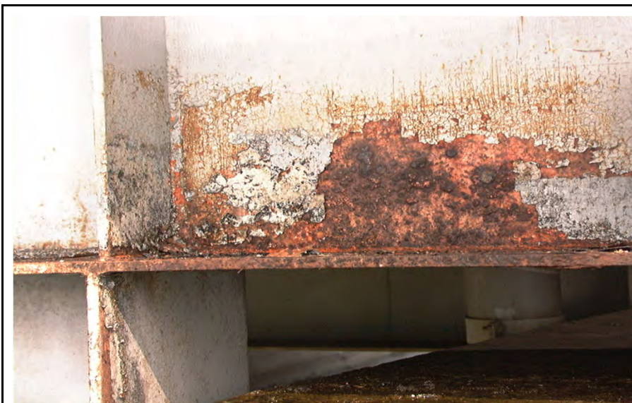
写真番号 1.1.1 説明 集中的に錆が発生した例(塗装橋)
