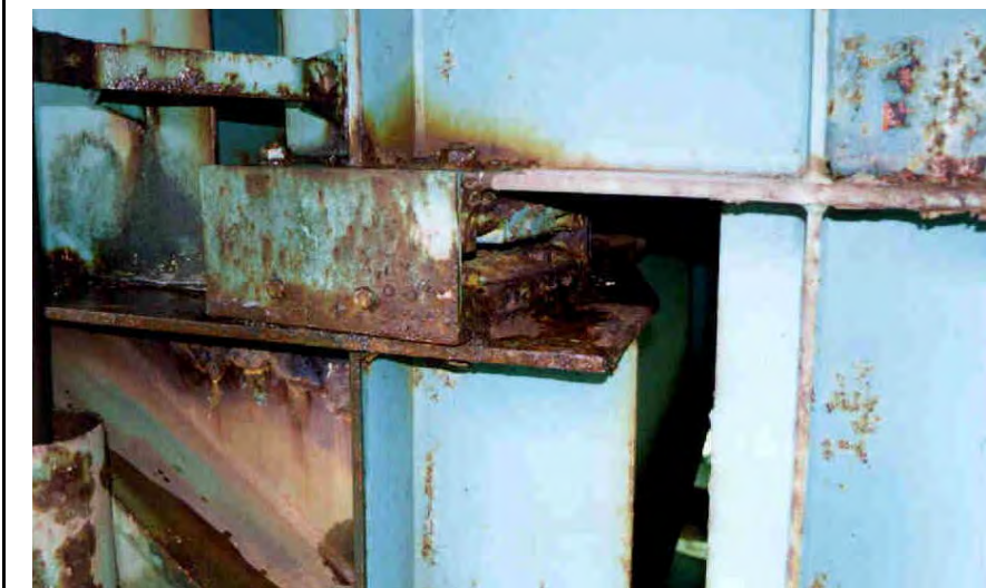
写真番号 15.1.4 説明 著しい腐食により、鋼製支承の変位追従機能が損なわれている状態の例
