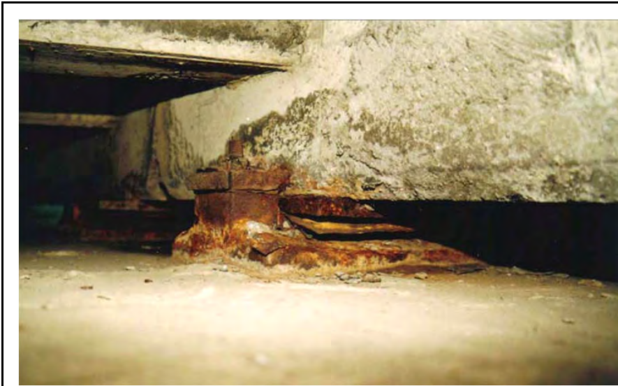
写真番号 15.1.3 説明 著しい腐食により、鋼製支承の荷重支持機能が損なわれている可能性がある状態の例
