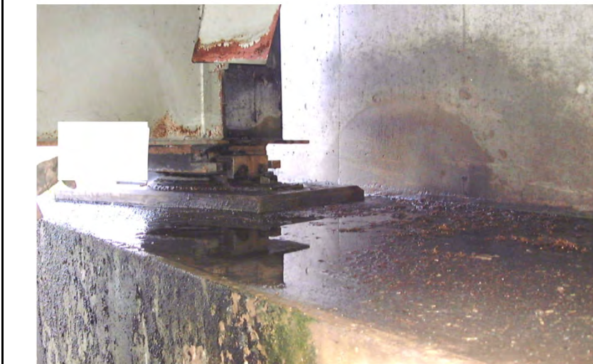
写真番号 19.1.4 説明 橋座に滞水した例
