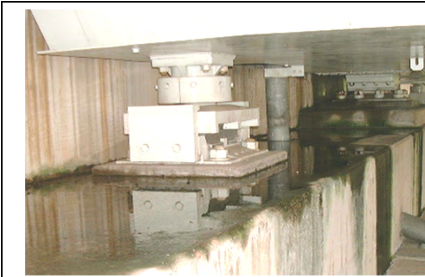
写真番号 19.1.3 説明 橋座に滞水した例
