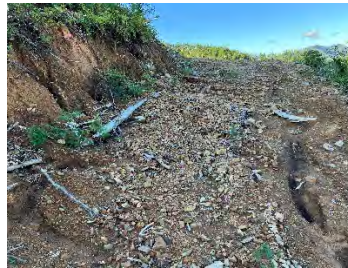
路面洗掘／集材路
