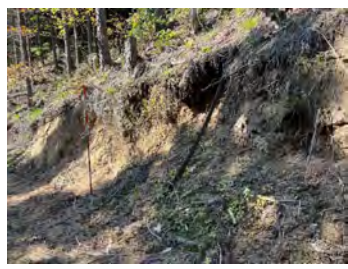
切土崩壊／森林作業道
