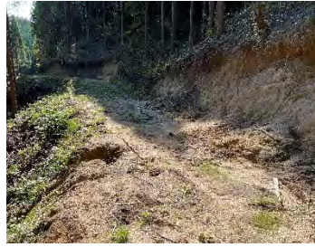
路肩崩壊／森林作業道
