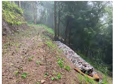
路体崩壊（修復済）／森林作業道
