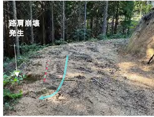
外カーブからの排水が路肩に流れこんでいる
