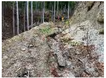
路面洗掘／森林作業道
