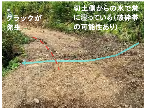
排水箇所直近でクラックが発生
