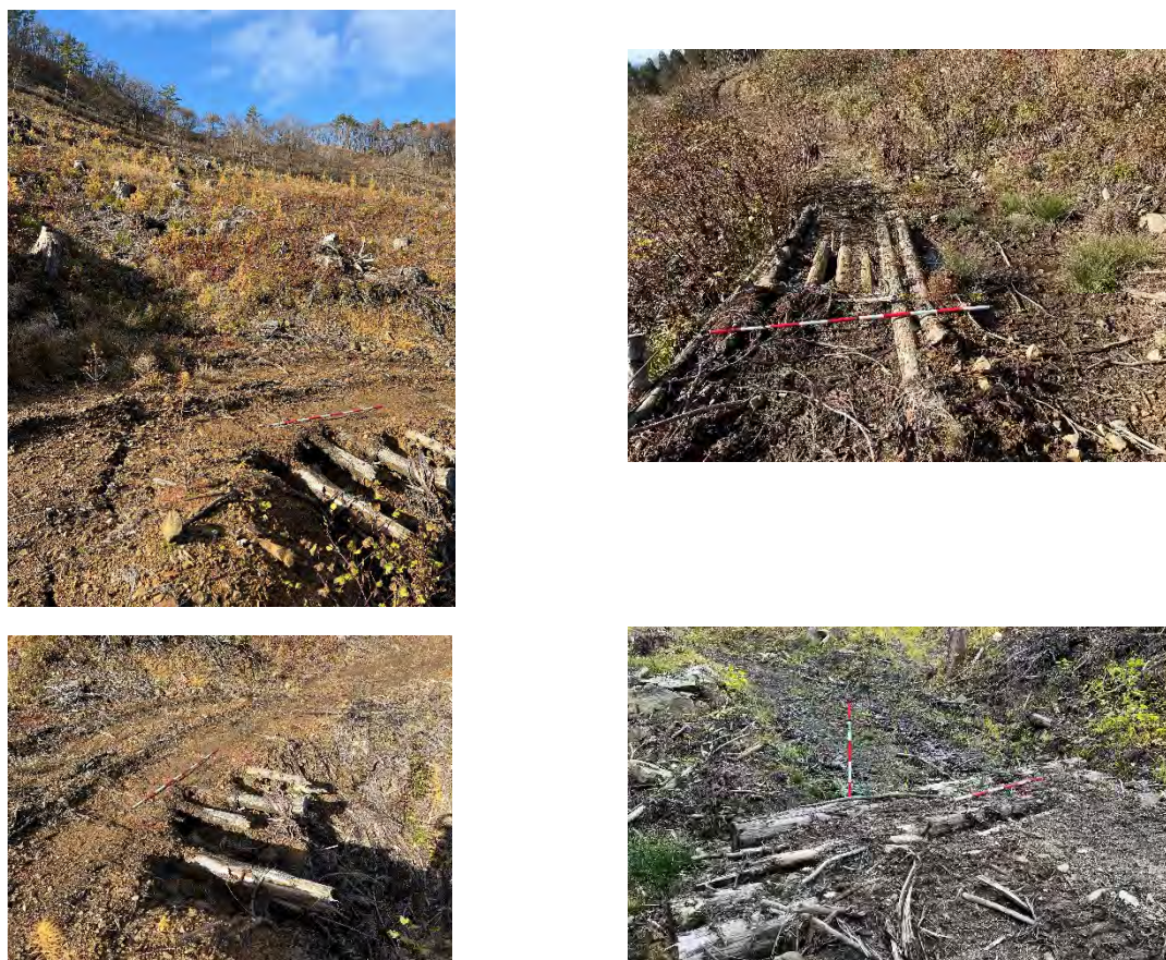
図 2.2-29 窪地の路体補強と侵食発生状況
