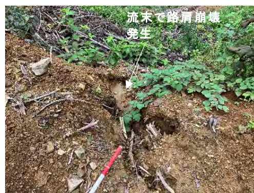
横断溝の流末から路肩が崩壊
