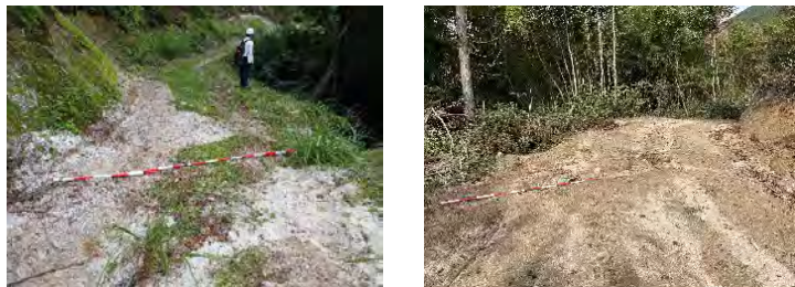
図 2.2-24 横断溝の土砂堆積状況
