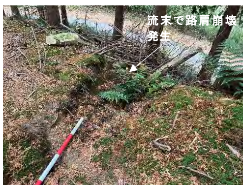
横断溝の流末から路肩が崩壊
