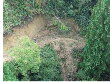
路体崩壊／集材路
