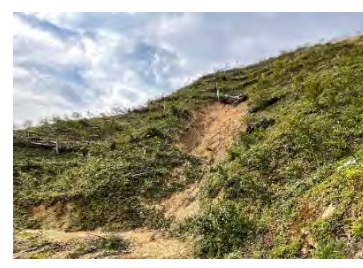
山腹崩壊／森林作業道
