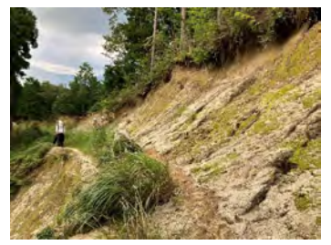
切土崩壊／森林作業道
