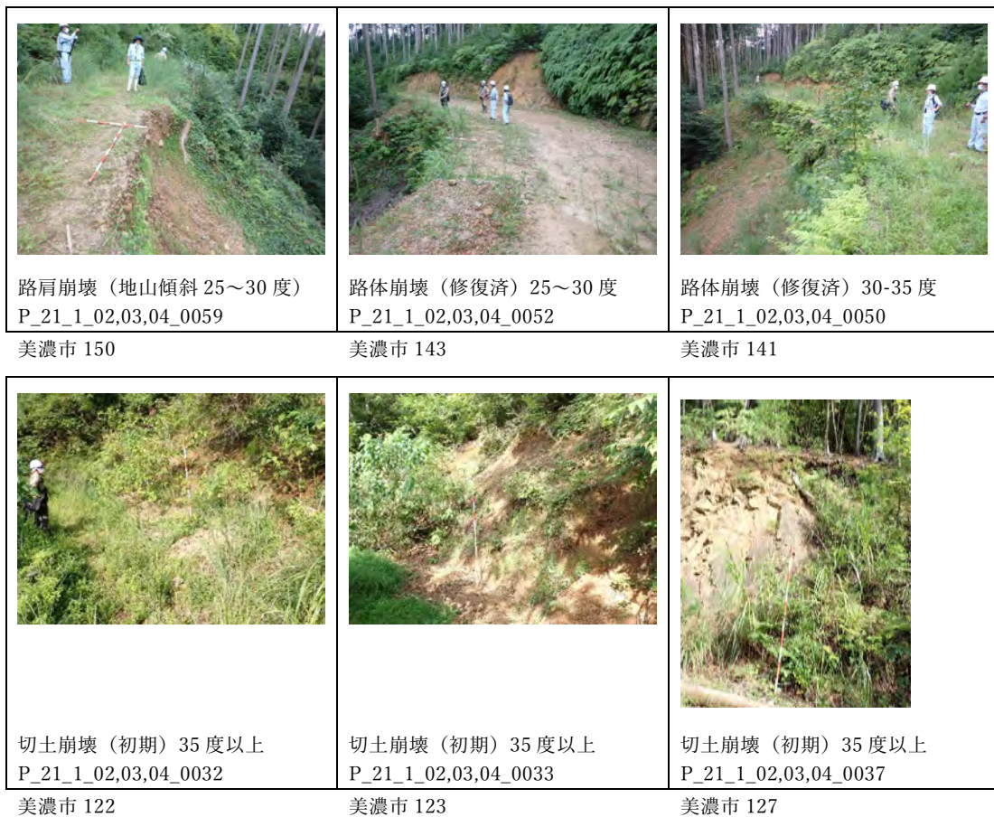
図 2.1-112 切土の被災（切土崩壊）
