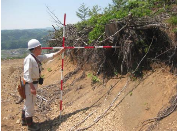
写真-2.35 森林作業道の切取法面の侵食が進行し、切株が崩落しそうである。
