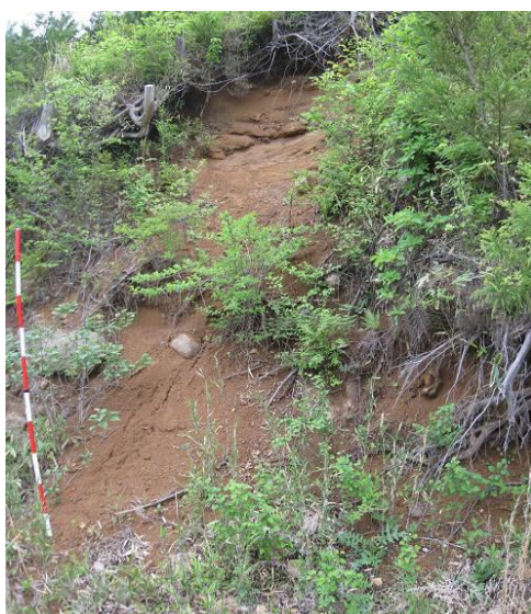
写真-2.57 法頭上部が崩落 浮き上がった根株含む崖が残留
