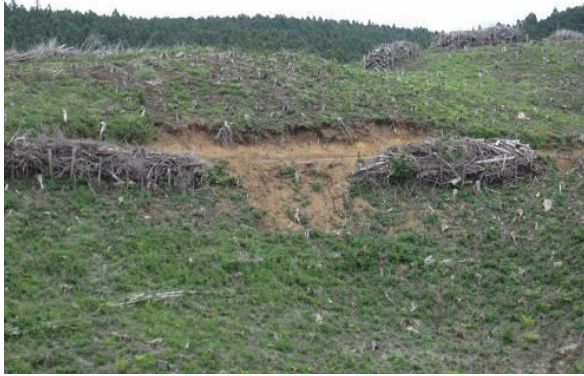
写真-2.61 残材集積が途切れた箇所での 土砂流出
