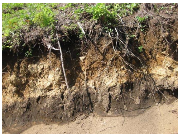
写真-2.55 森林作業道の切取法面が拡大している
