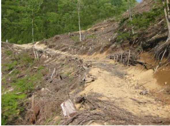
写真-2.38 集材路の路肩から、土砂流出が認められる。
