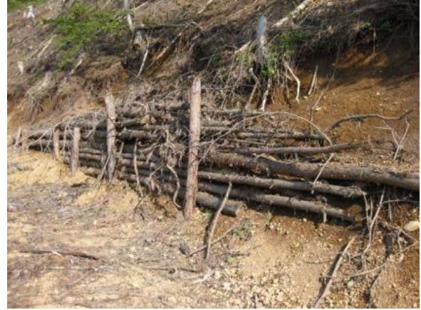
写真-2.39 集材路切取法面下部に、伐採木や枝条を利用した柵工が設定されている箇所が存在する。
