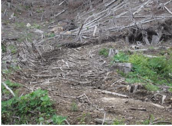
写真-2.65 流水侵食が進んだ路面
