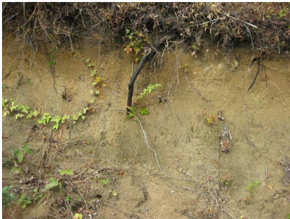
写真-2.19 急斜面尾根部の崩壊地
