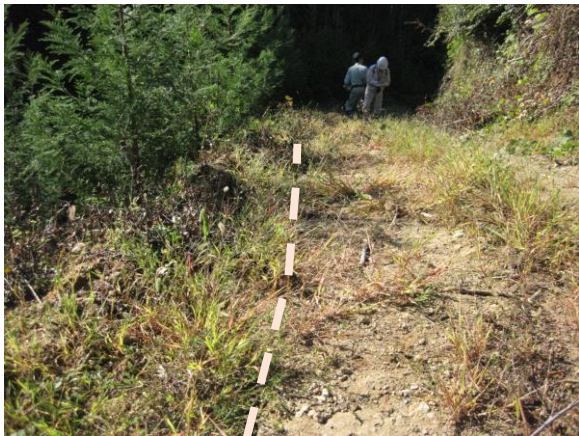
写真-2.3 森林作業道の路肩盛土部分の亀裂発生箇所 (L=10.6m、W=0.1m、H=0.2m)
