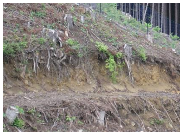
写真-2.64 伐根が浮き上がった状態の切り 取りのり面
