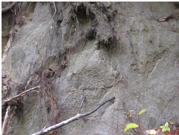
写真-2.18 森林作業道下の崩壊地
