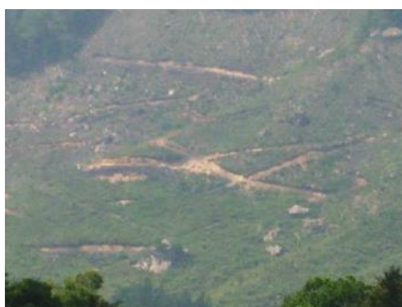
写真-2.53 森林作業道の切取法面が拡大している箇所が見受けられる。
