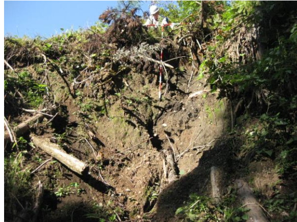
写真-2.2 森林作業道の路肩決壊
