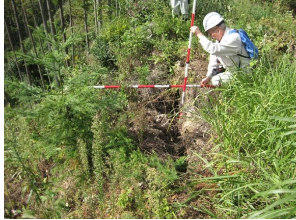
写真-2.7 森林作業道路肩の亀裂 (支溪右岸斜面)
