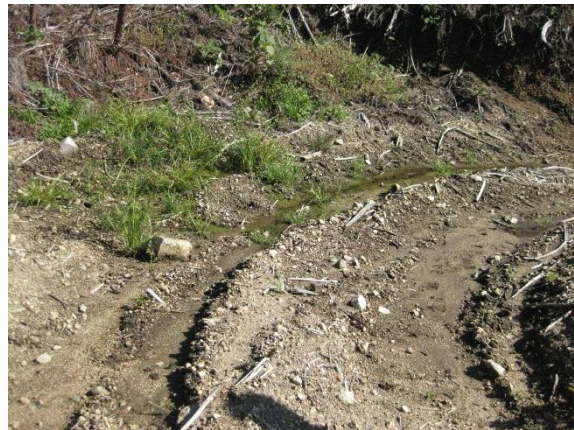
写真-2.13 森林作業道路面の滞水箇所 (排水処理が必要)
