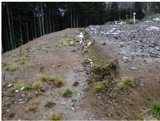
写真-3.18 土場の段差
