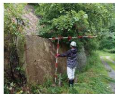
設置したコンクリート擁壁 (熱水の影響を受けて茶色く変色している)
