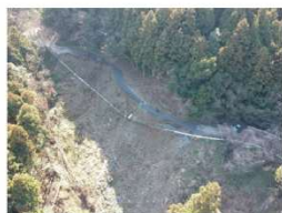
被災状況 (H30.7.7)
