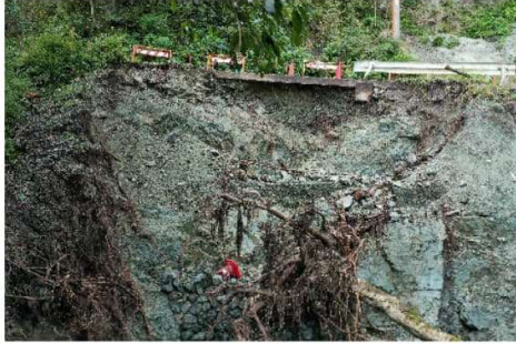
UAVによる被災箇所の撮影
