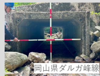
岡山県ダルガ峰線 ボックスカルバートで土砂や流木の堆積・詰まりを軽減
