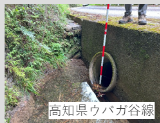
高知県ウバガ谷線 暗渠入口の簡易で大型な樹根が詰まり、水が溢れている様子
