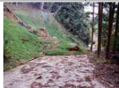
写真① 林道内の堆積土砂の状況
