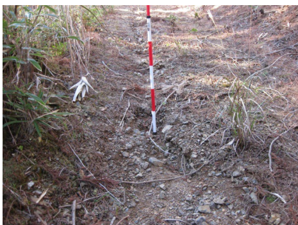
写真-2.94 路面洗掘の状況
