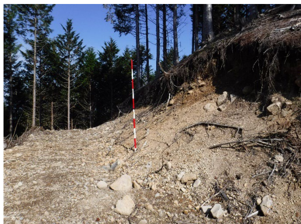
写真-2. 40 切土崩壊の状況
