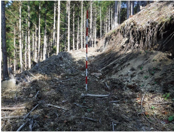
写真-2. 41 切土崩壊の状況 (軽石層の崩壊が連続する)
