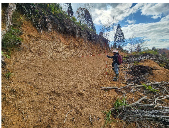
写真-2. 23 切土崩壊の状況
