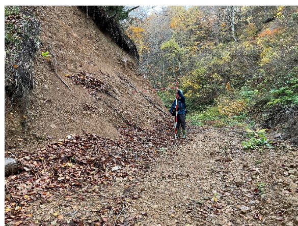
写真-2.22 切土崩壊の状況
