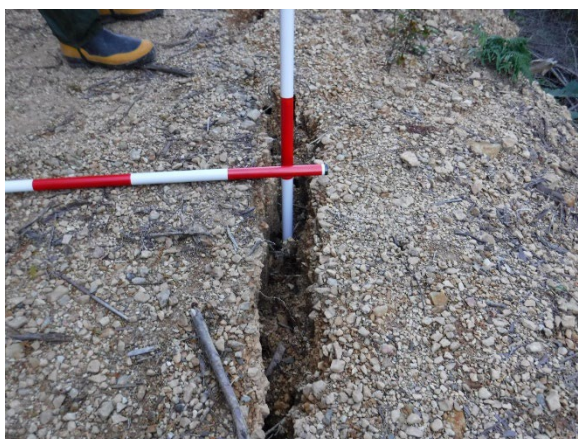
写真-2. 61 クラックの状況（拡大）
