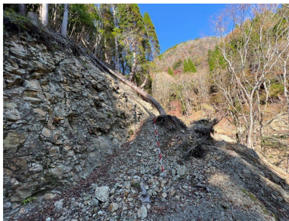
写真-2.89 切土崩壊の状況
