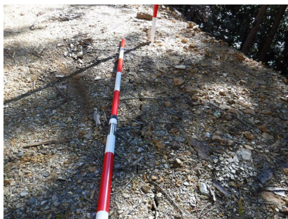
写真-2.66 クラックの状況（拡大）
