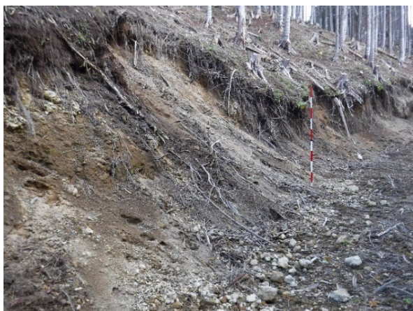
写真-2.7 切土崩壊の状況 (群一作-04)
