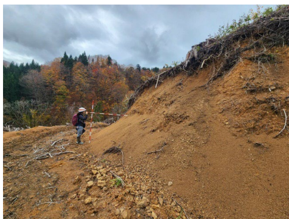
写真-2.2 切土崩壊の状況 (山一作-02)
