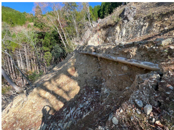
写真-2.86 路肩崩壊の状況
