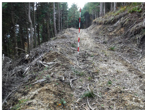
写真-2. 36 路面洗掘の状況
