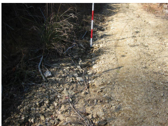
写真-2.99 路面洗掘の状況
