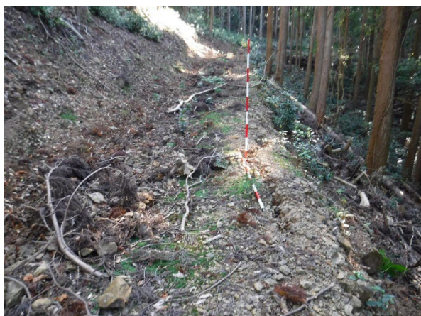
写真-2.53 クラックの状況
