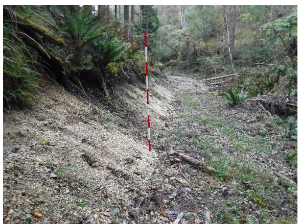
写真-2.34 切土崩壊の状況 (軽石層の崩壊が連続する)
