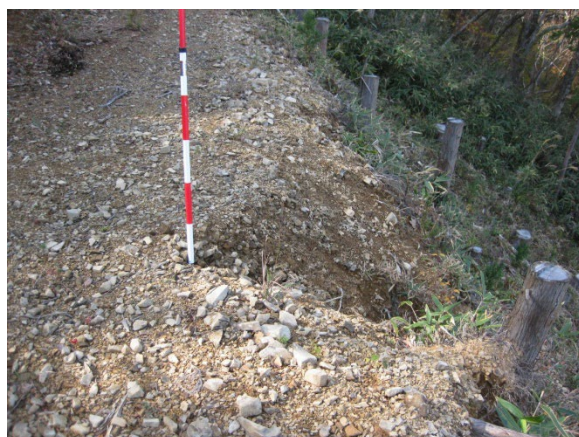
写真-2.97 路肩崩壊の状況
