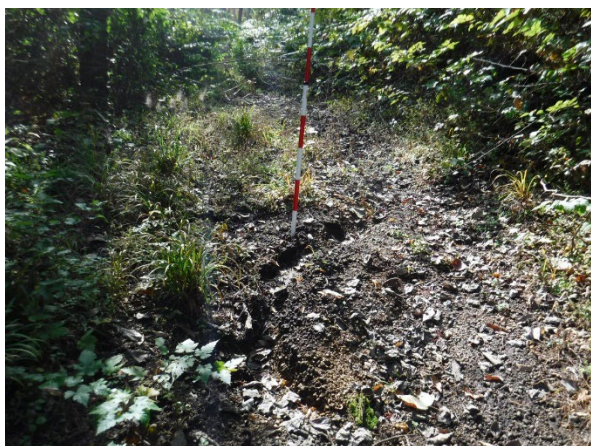
写真-2.5 路面洗掘の状況 (群一作-01)
