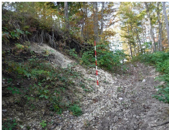
写真-2.32 切土崩壊の状況（軽石層）
