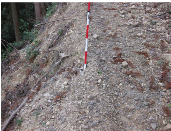
写真-2.68 路肩崩壊の状況
