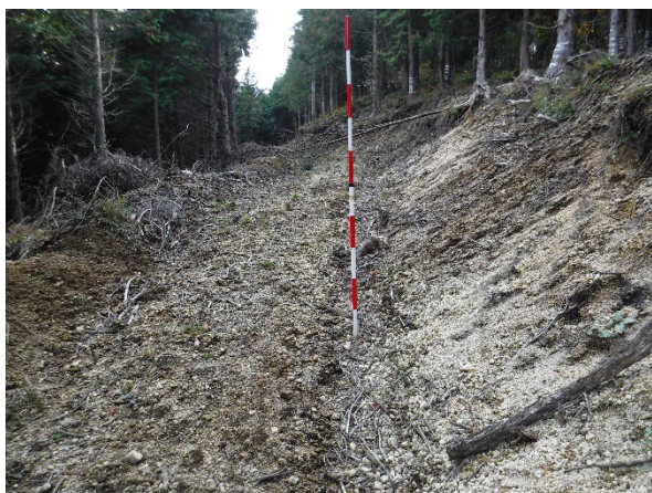
写真-2. 37 路面洗掘と切土崩壊の状況 (軽石層の崩壊が連続する)
