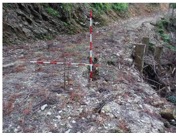
写真-2.50 クラックの状況
