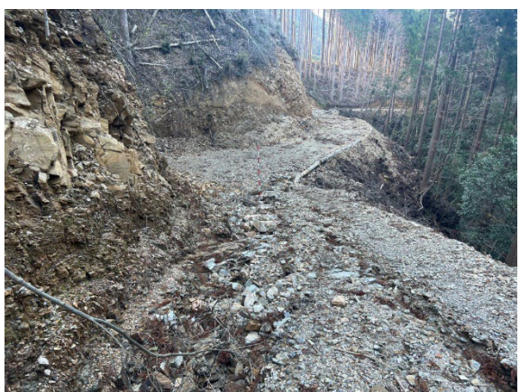
写真-2.90 路面洗掘の状況
