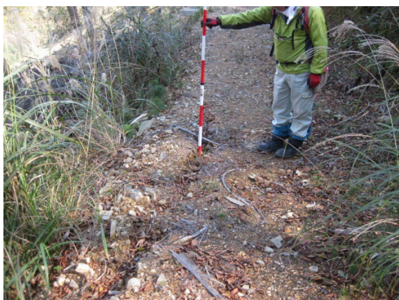
写真-2.96 クラックの状況
