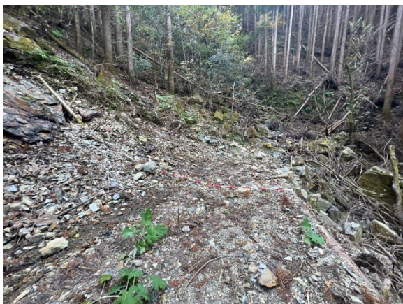
写真-2.88 切土崩壊の状況
