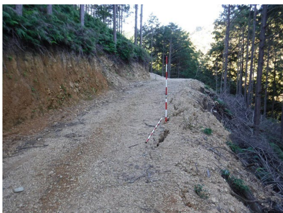
写真-2. 60 クラックの状況
