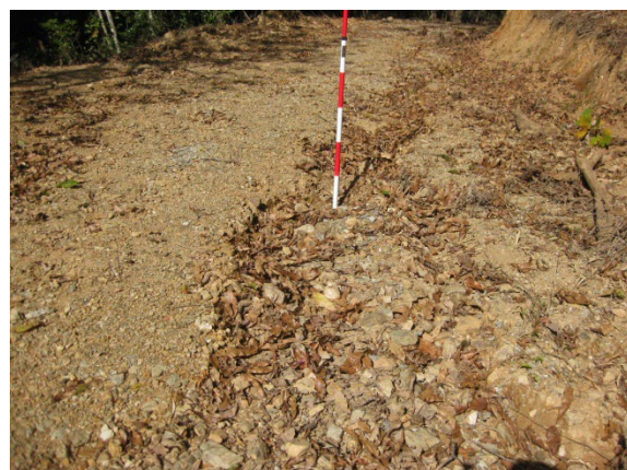
写真-2.104 路面洗掘の状況
