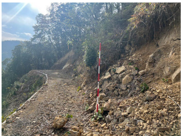
写真-2.11 切土崩壊の状況 (宮一作-30)
