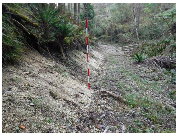
写真-2.6 切土崩壊（軽石層）の状況 (群一作-02)
