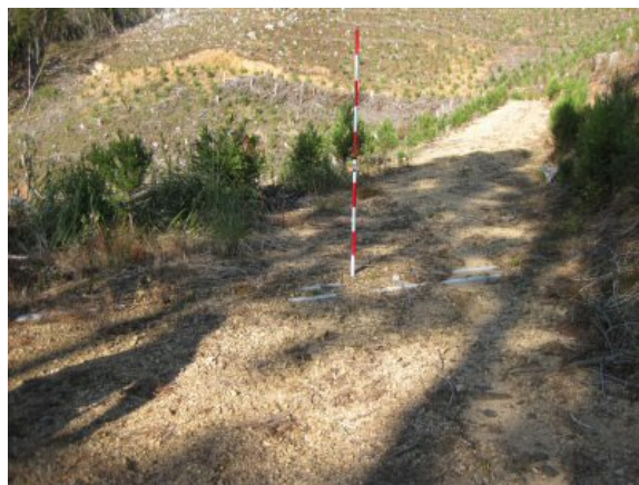
写真-2.12 コンクリート横断溝の土砂堆積状況 (宮一作-29)
