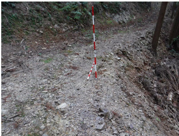
写真-2. 55 クラックの状況
