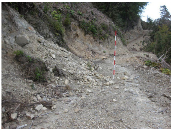
写真-2.106 切土崩壊の状況
