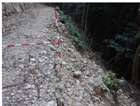
写真-2.52 路肩崩壊の状況
