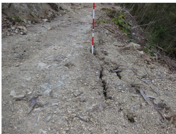
写真-2.107 クラックの状況
