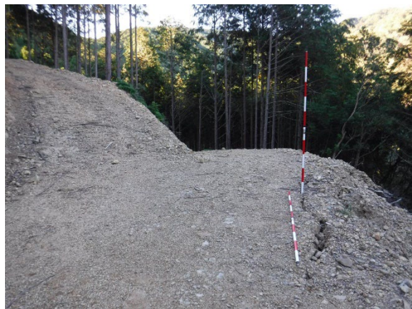
写真-2. 59 クラックの状況
