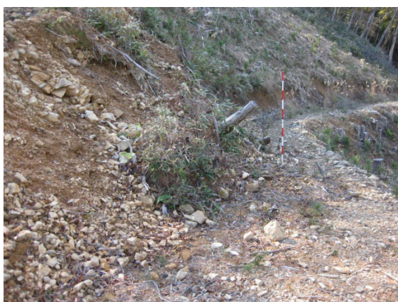
写真-2.98 切土崩壊の状況
