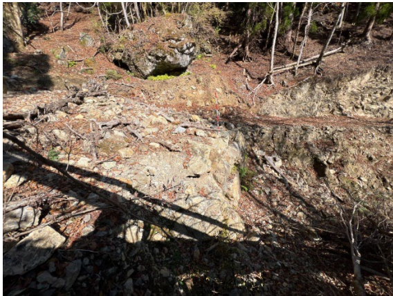
写真-2. 82 路体崩壊の状況
