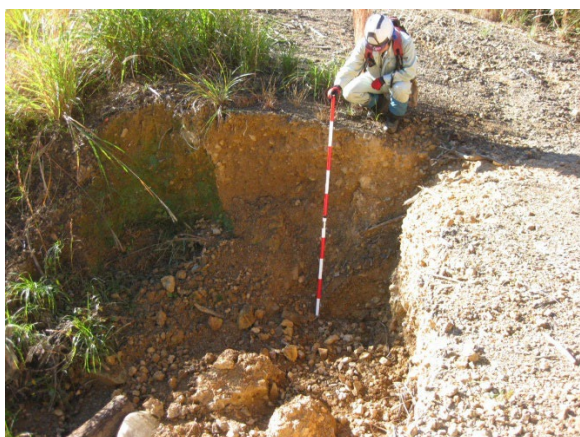
写真-2.91 路肩崩壊の状況
