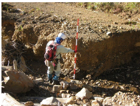
写真-2.92 路体崩壊の状況
