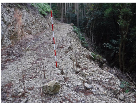
写真-2.51 クラックと路肩崩壊の状況
