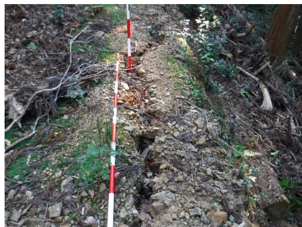
写真-2.54 路肩崩壊の状況（拡大）
