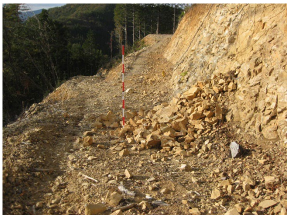
写真-2.101 切土崩壊の状況
