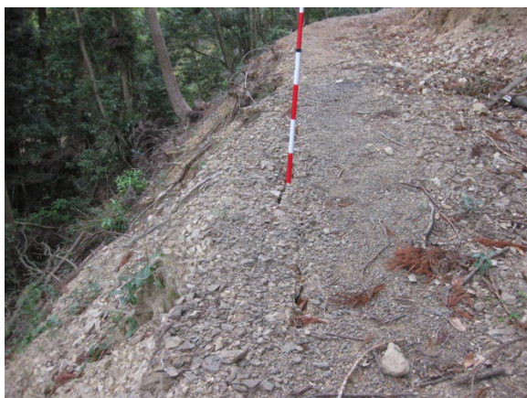
写真-2.67 クラックの状況
