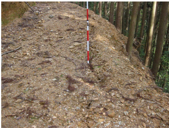
写真-2.76 クラックの状況
