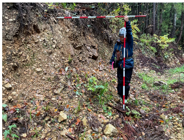
写真-2. 28 切土崩壊の状況
