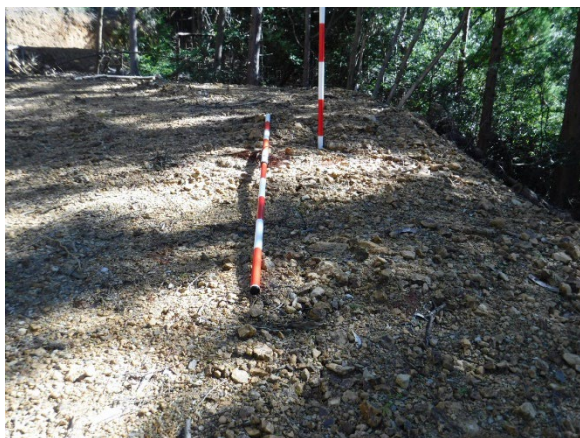
写真-2.65 クラックの状況
