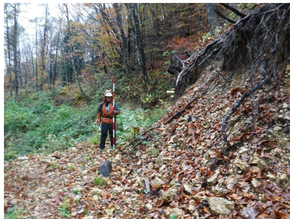
写真-2.14 切土崩壊の状況
