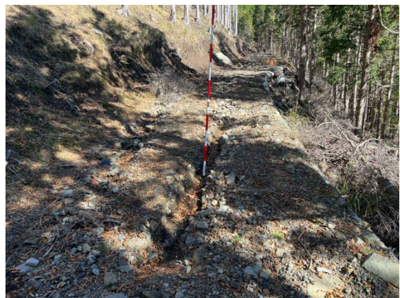
写真-2.80 路面洗掘の状況
