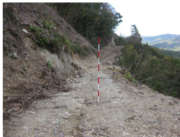
写真-2.108 路面洗掘の状況
