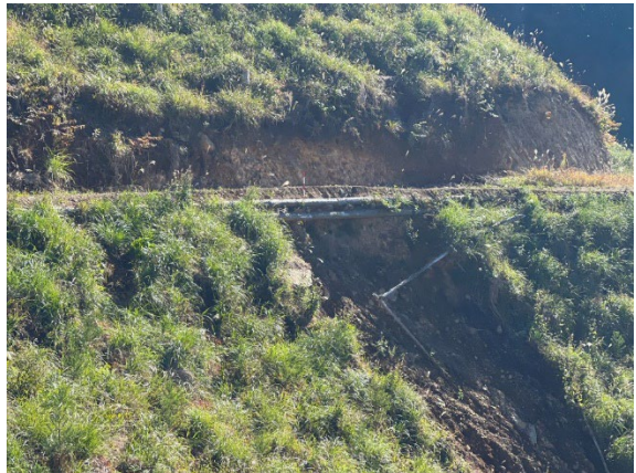
写真-2.78 路肩崩壊の状況
