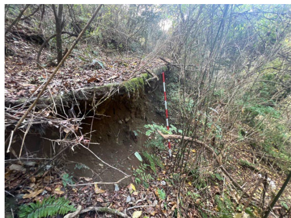
写真-2. 85 路肩崩壊の状況
