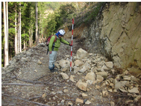
写真-2.102 切土崩壊の状況
