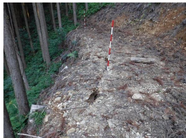
写真-2.48 クラックの状況 (路体崩壊が始まりつつある)
