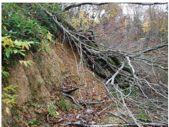
写真-2.19 切土崩壊の状況
