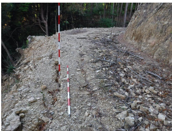
写真-2.47 クラックの状況 (内側にもクラックが発生)
