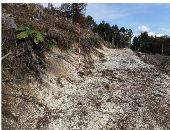
写真-2.31 切土崩壊の状況 (軽石層の崩壊が連続する)
