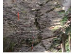
盛土で発生したクラック
