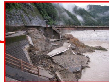
国道219号線の被災状況 （球磨橋付近）
