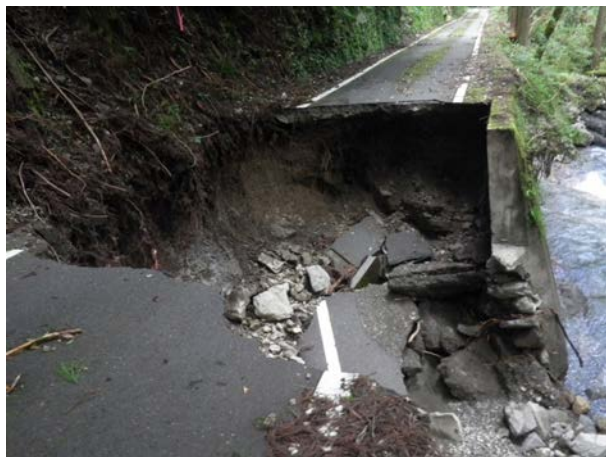
7月豪雨(高知県安芸市)
