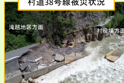
村道38号線被災状況
