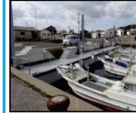
漁業作業の効率化と安全対策のための漁港整備（岸壁改良）
