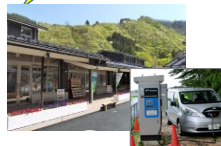
EV車等への給電設備
