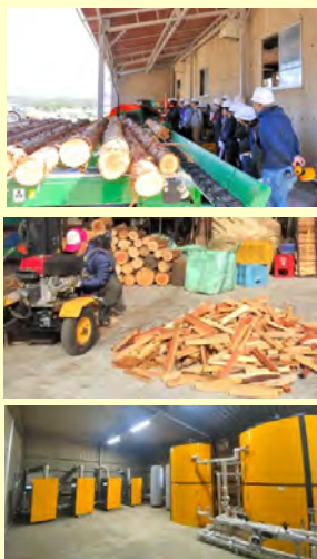
コテージ「毛無山荘」の暖房・大浴場の熱源を木質バイオマスボイラーに転換
