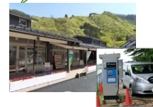
EV車等への給電設備
