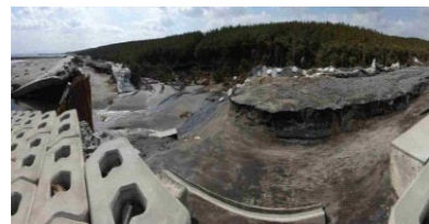
防潮堤及び海岸防災林の被災
