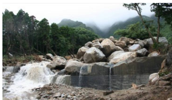
治山ダムの被災
