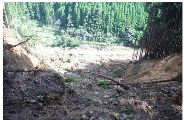
崩壊箇所源頭～下方
