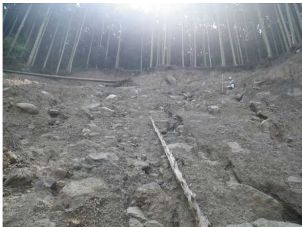
崩壊箇所源頭部
