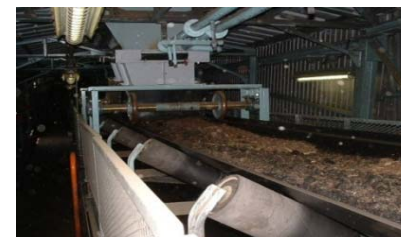
③石炭と共に発電施設内へ移動
