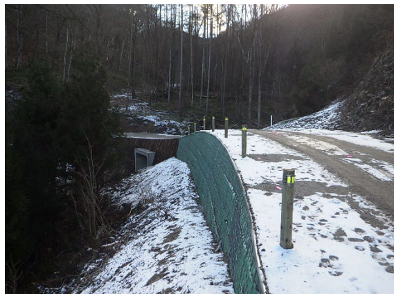
視線誘導標 (群馬県利根郡川場村) [国有林林道事業]
