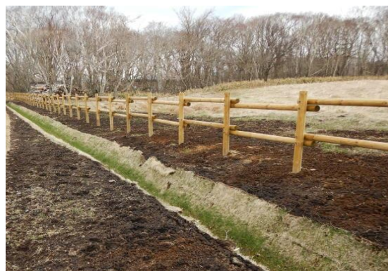
転落防止柵（北海道別海町） [国営かんがい排水事業]
