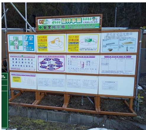
工食用掲示板（滋賀県東近江市） [農業水利事業]
