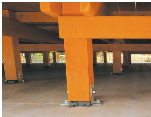
写真 3-3 木造住宅用の基礎パッキンを用いてコンクリートと木の束を絶縁した例
