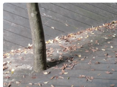
落ち葉が堆積しているウッドデッキ
