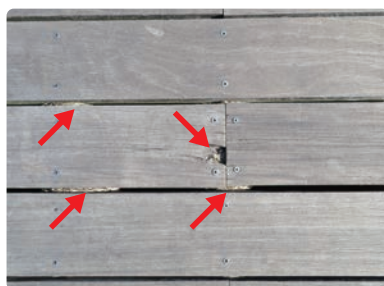
ウッドデッキ床板材に生じた欠損及び 根太材の上に堆積した枯芝
