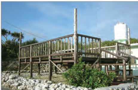
写真 4 暴風雨による塗膜剥離
