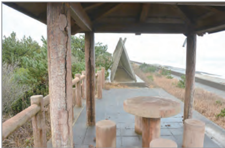
写真 2 汀線付近での塩害
