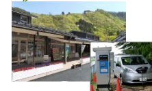
EV車等への給電設備
