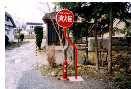
消防に関する施設 (消火栓)
