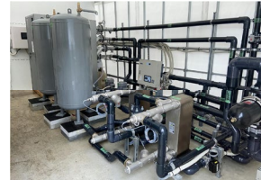
木質資源利用ボイラー
