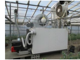
ヒートポンプ
