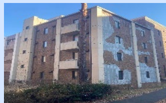
外壁の剥離、落下
