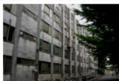
落下の危険がある外壁
