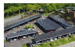
創エネルギー設備の整備
