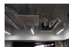
高効率空調・全熱交換器の整備
