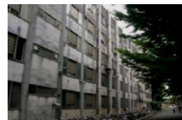
落下の危険がある外壁
