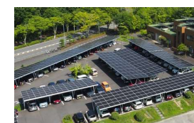
創エネルギー設備の整備
