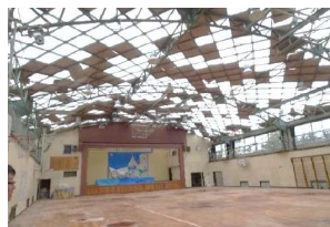
台風で屋根が消失した体育館
