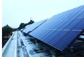
創エネルギー設備の整備
