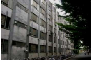
落下の危険がある外壁
