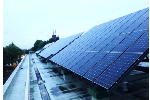
創エネルギー設備の整備
