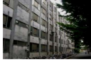
落下の危険がある外壁
