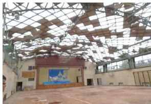
台風で屋根が消失した体育館
