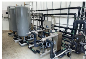
木質資源利用ボイラー
