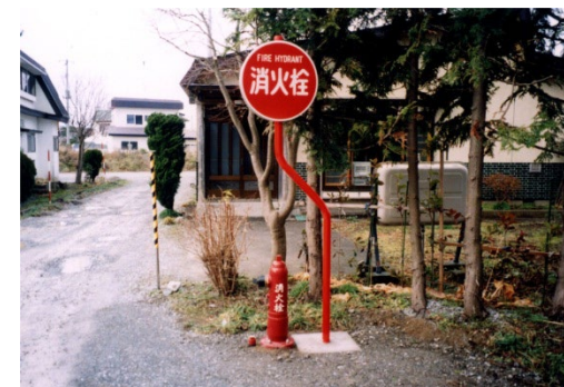
消防に関する施設 (消火栓)
