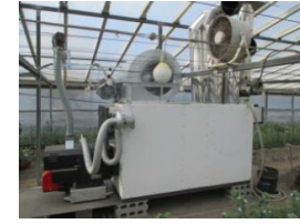
ヒートポンプ
