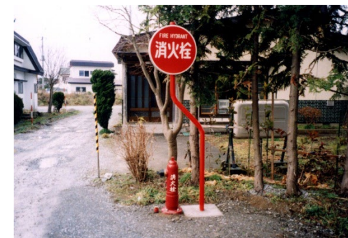
消防に関する施設 (消火栓)
