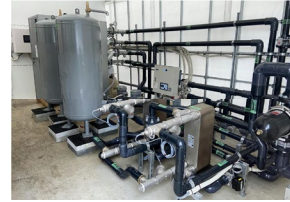
木質資源利用ボイラー
