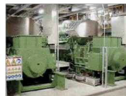
写真: ガスエンジン発電機
