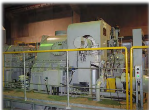
写真: 発電施設
