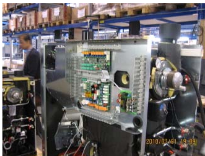
図 3.1-8 ボイラーに搭載された制御ボード
