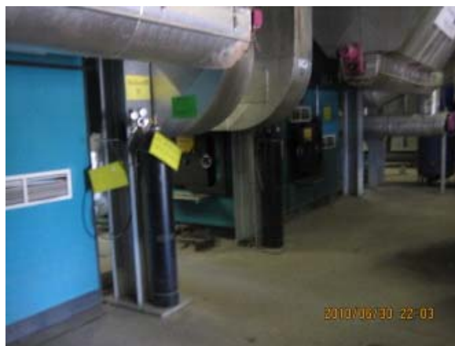
図 3.1-4 チップボイラー
