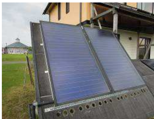
図表 IV-3 太陽光パネル
