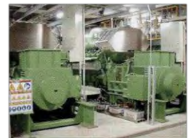
写真:ガスエンジン発電機
