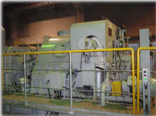
写真: 発電施設
