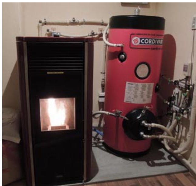
写真 7.1 温水供給機能付ペレットストーブ（ラベリ）と貯湯槽の導入事例（京都府）
