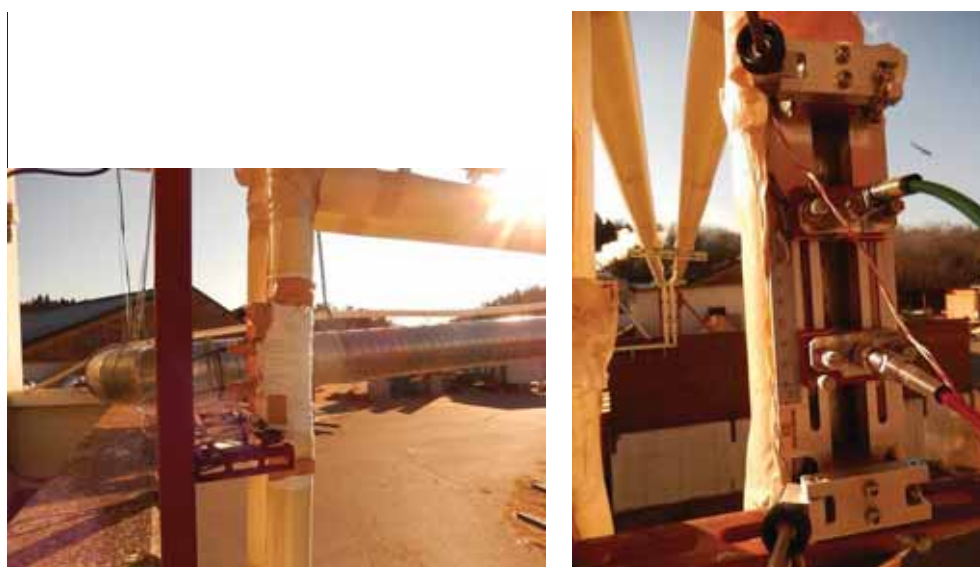
図表 5-4 温水供給配管への熱量計設置状況②
