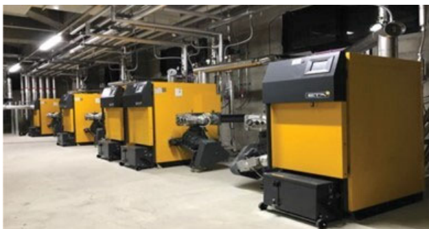
—チップボイラー—
