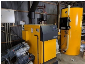
ボイラー・ バッファタンク
