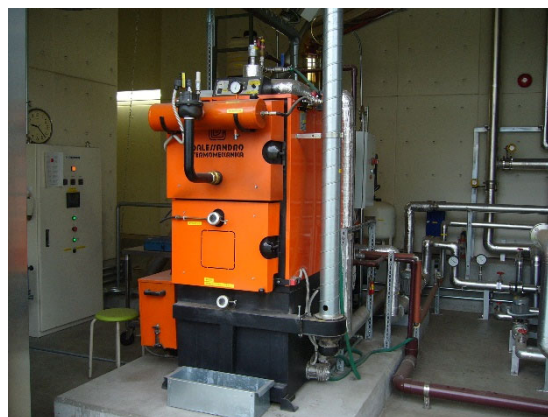
チップボイラー本体
