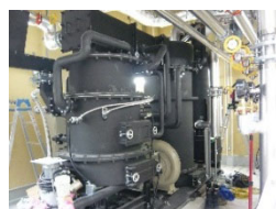
木質バイオマス 温水ボイラー
