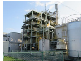
木質バイオマスボイラ施設
