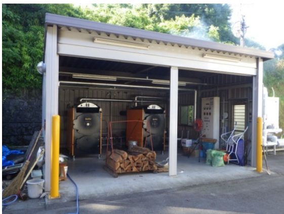
薪ボイラー棟
